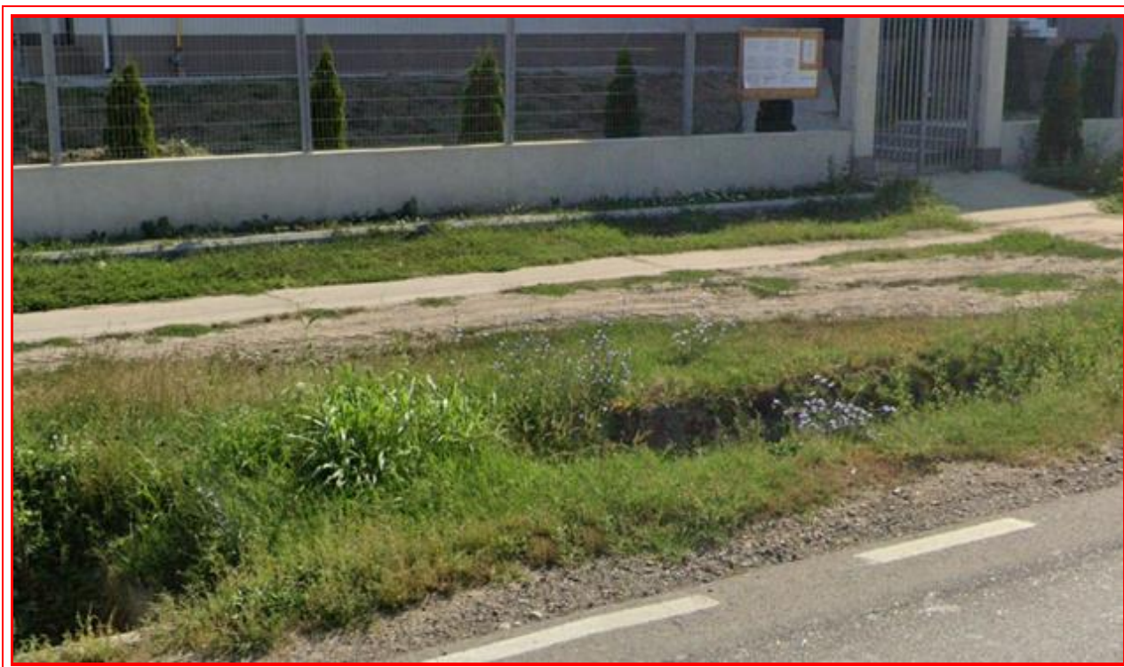
Figura 03. Prezentarea situației existente a trotuarelor adiacente DN 25 – partea stângă din Comuna Ivești, Județul Galați
