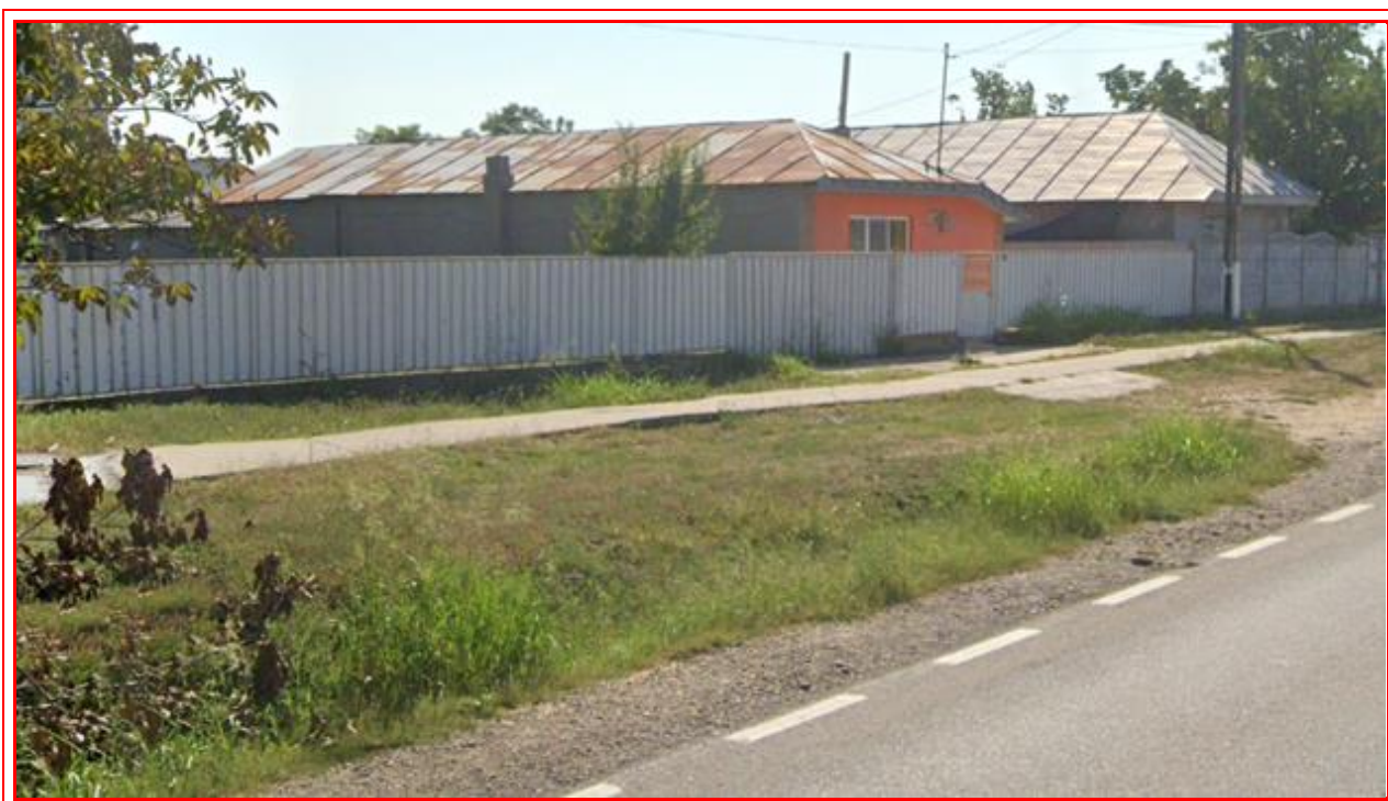
Figura 04. Prezentarea situației existente a trotuarelor adiacente DN 25 – partea stângă din Comuna Ivești, Județul Galați
