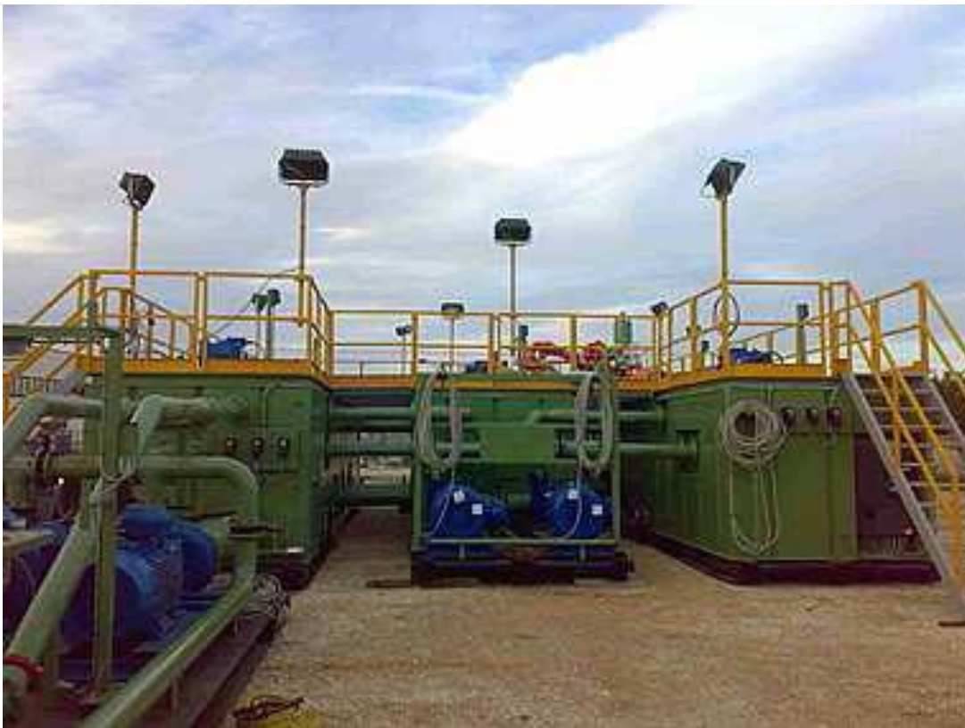
Sistemul de depozitare a fluidului de foraj la sonde
