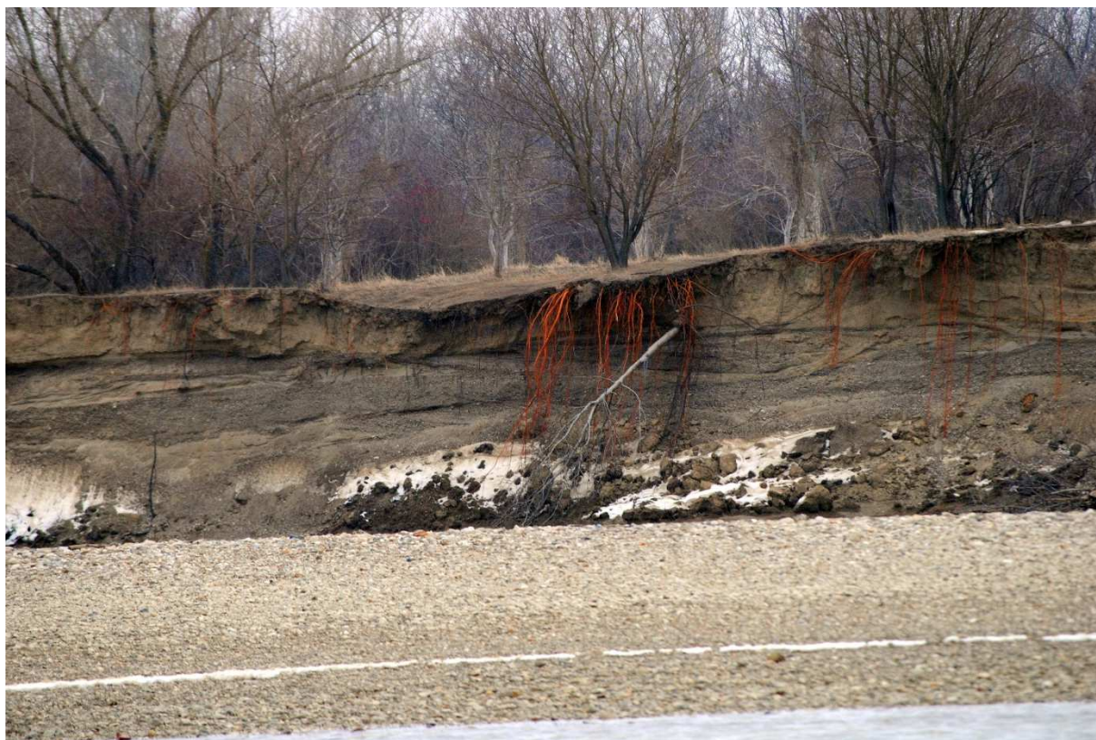
Figura nr. 1. Eroziunea activă a malului drept al râului Siret în zona analizată
