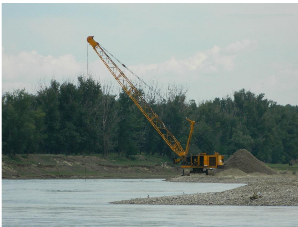
Fig. 26 Exploatarea agregatelor minerale direct din șenalul principal (exploatarea de pe malul drept mai în aval, iulie 2018)
