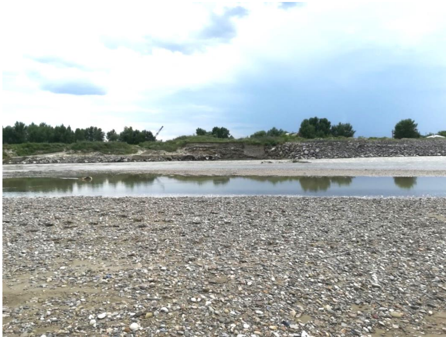
Fig. 28 Distrugere apărare mal Suraia
