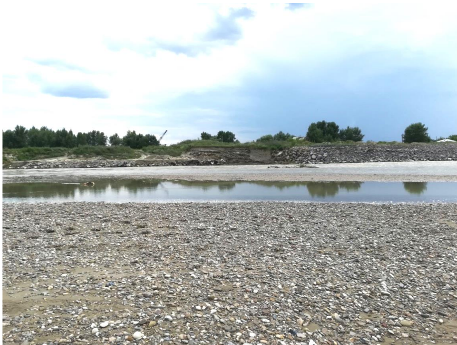
Fig. 28 Distrugere apărare mal Suraia
