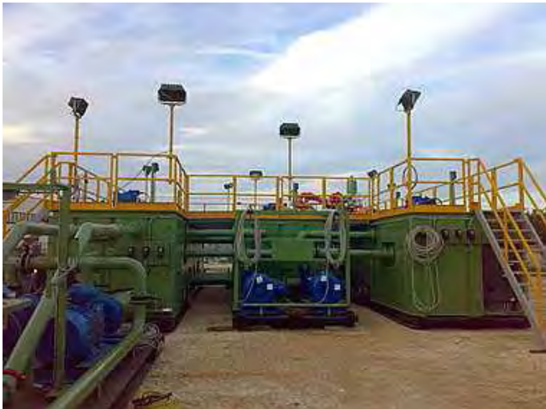
Sistemul de depozitare a fluidului de foraj la sonda
