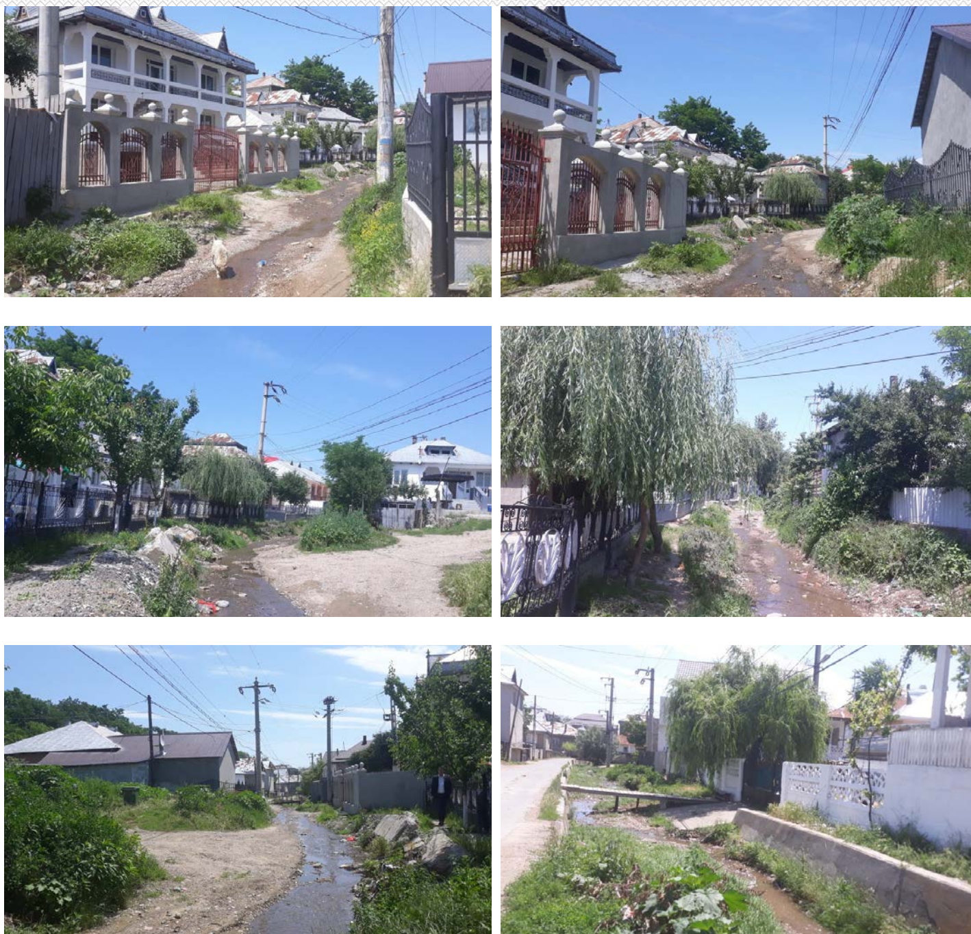
Colaj 02. Prezentarea situatiei existente in punctul podului "Ferent" din Comuna Brahasesti, judetul Galati.
