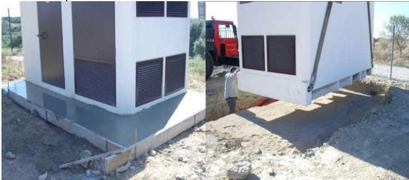
Fig.4. Fotografie informativa de poziționarea a transformatorului
