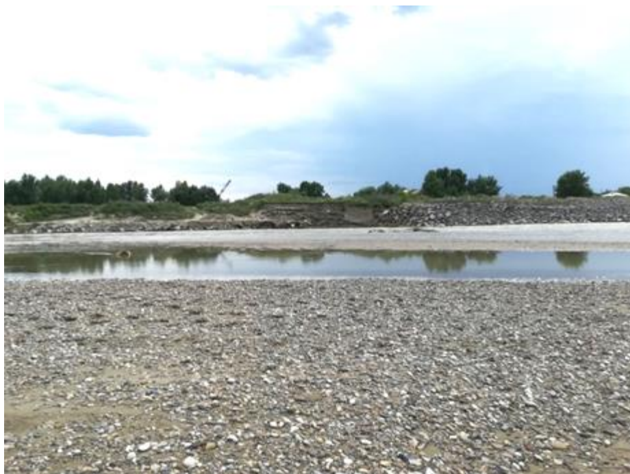
Fig. 68 Distrugerea apărării de mal în dreptul localității Suraia
