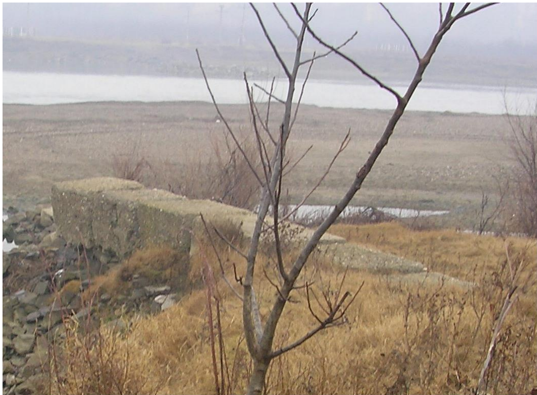
Fig 6 . E-piu din beton in capatul aval al perimetrului S.C. Somaco Holding S.A.
