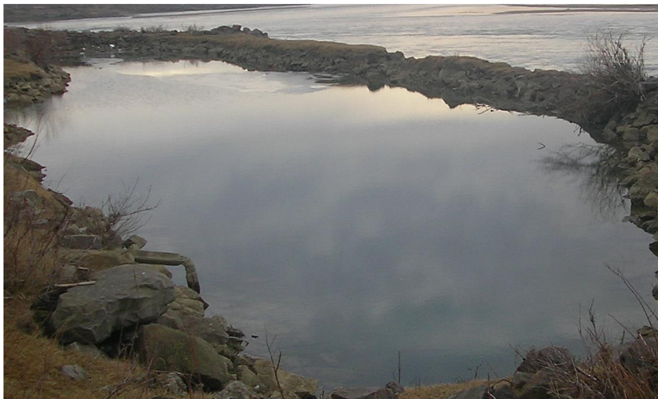
Fig 7 . Aparare de mal executata din blocuri de piatra lestate pe suluri de fascine
