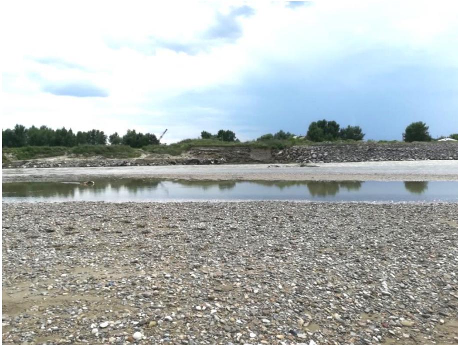
Fig. 5 Distrugerea apărării de mal în dreptul localității Suraia
