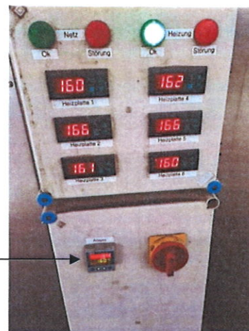
Imaginea nr. 2 – Panou control temperature
