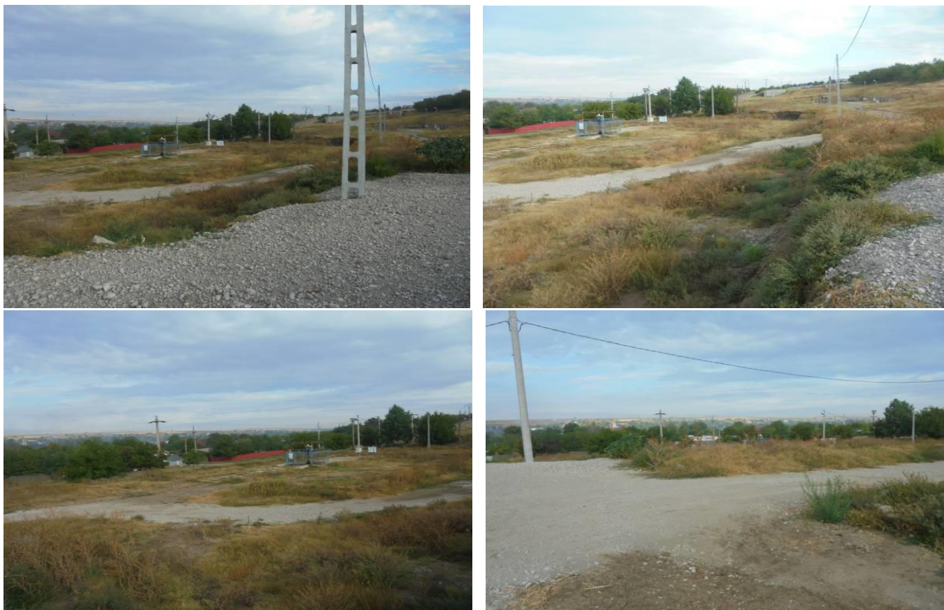
Imagini cu perimetrul pe care urmează a se amenaja platforma necesară forajului sondei 35H Independența și a echipării de suprafață și montaj conductă de amestec sonda 35H Independența
