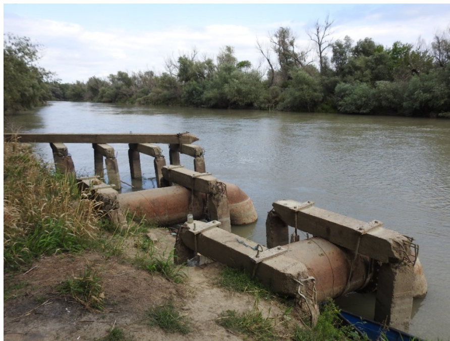
Figura nr. 46: Sistemul de captare, aflat în stare avansată de degradare
