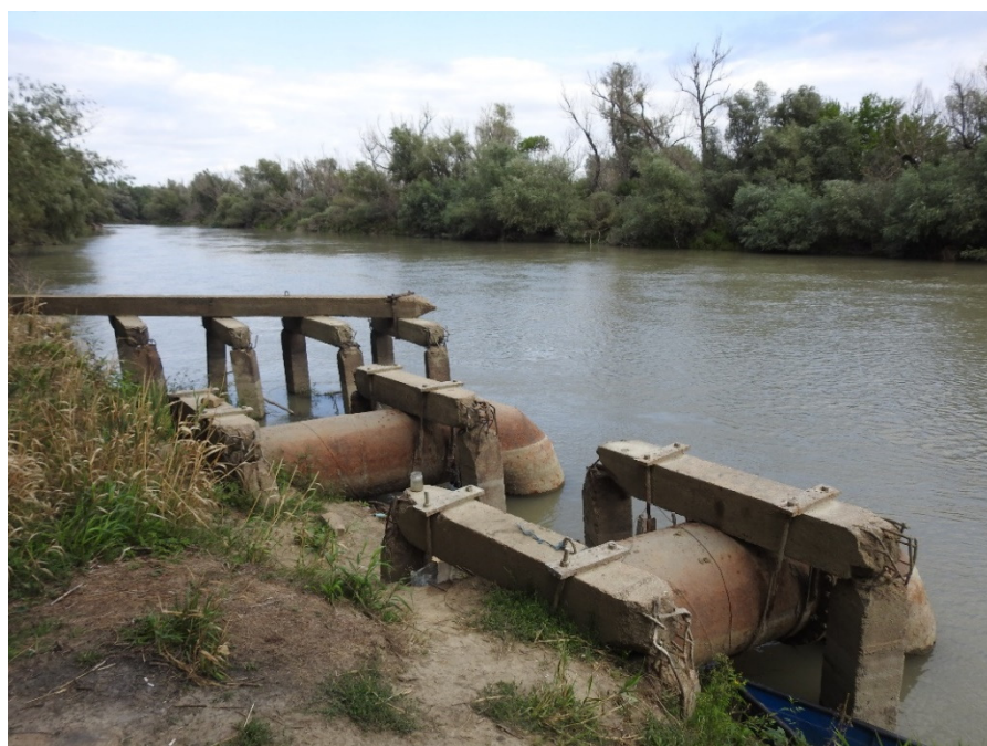
Figura nr. 80: Sistemul de captare, aflat în stare avansată de degradare
