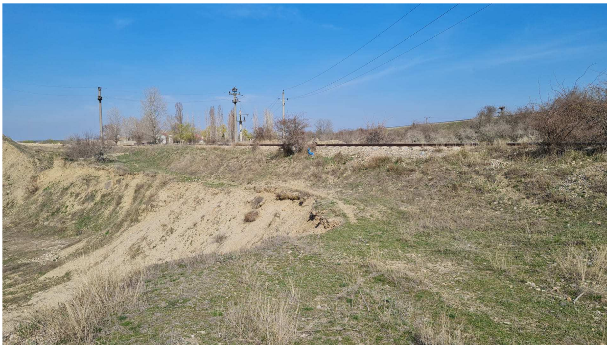
Figura nr. 25. Imagine de ansamblu asupra terenului analizat, anul 2023 (vedere spre calea ferată)
