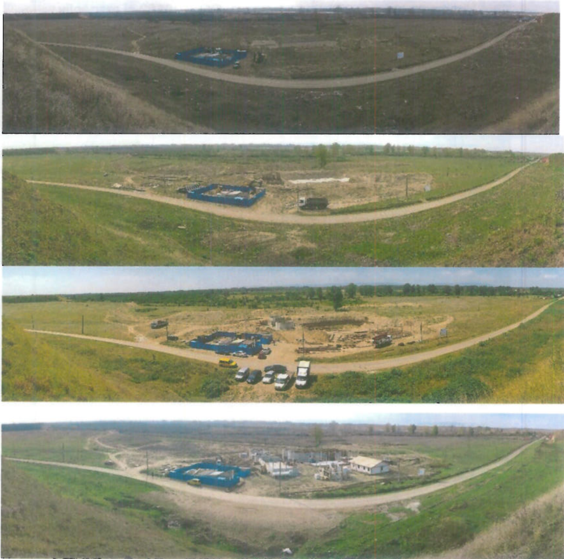
Fig.3 – Etape de constructie a SEAU Movileni surprinse cu ocazia vizitelor din teren in diferite sezoane ale anului
